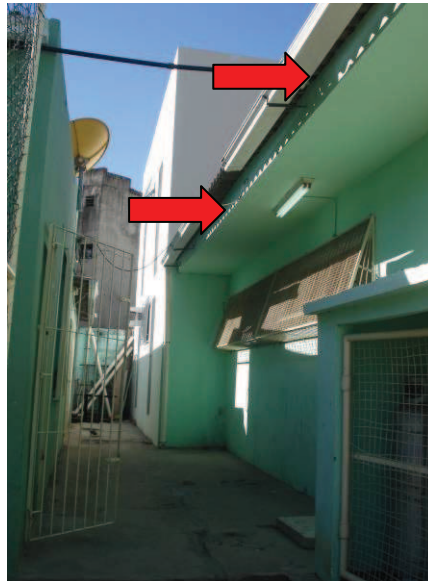
Figura 53 - Foto retirada pela autora que mostra o encontro entre a cobertura e a laje com a calha na borda.
